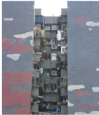
圖 7 重慶北路集合住宅高樓側牆，馬賽克剝落
